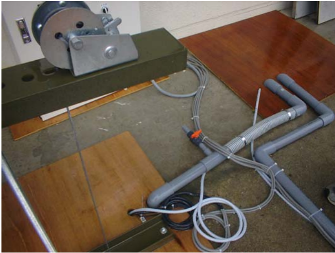
メカセラ水供給配管 左側 汚泥貯留槽 右側 汚泥濃縮貯留槽
